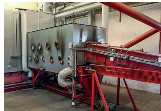
500 kW Heizleistung hat das „Höllengehen“. Über einen Luft-/Wasser-Wärmetauscher wird damit auch die Getreidetrocknung betrieben.
